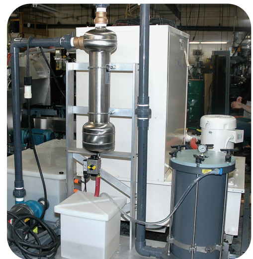
Sistema de recirculação de água para acoplamento
